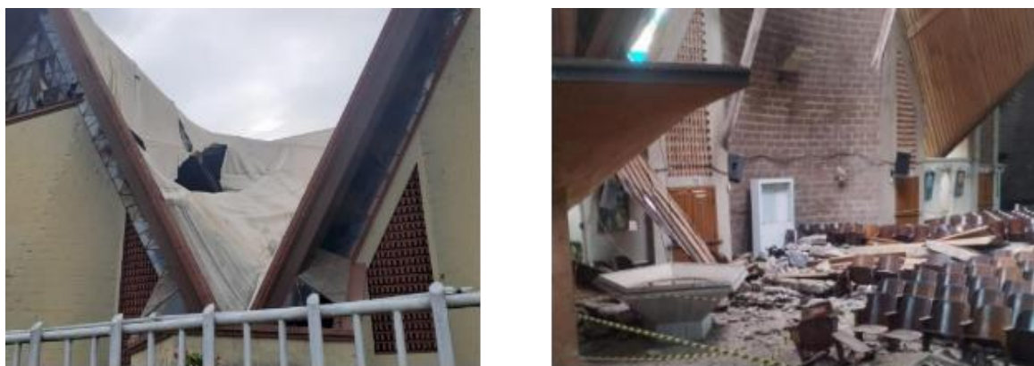
Figura 4 – Colapso da Cobertura da Co-Catedral de Coronel Fabriciano.
